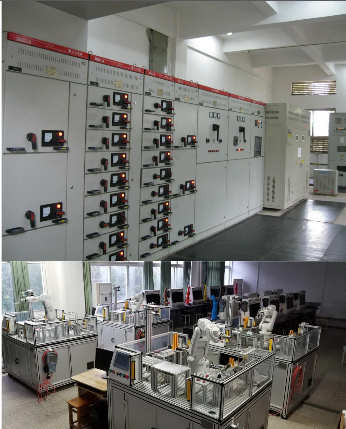
冷通道、配电柜、工业自动化系统
