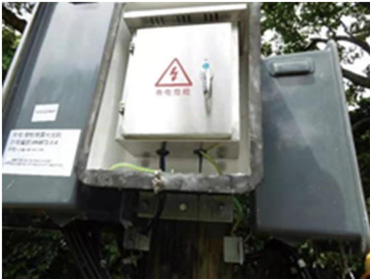
台区变监测项目
