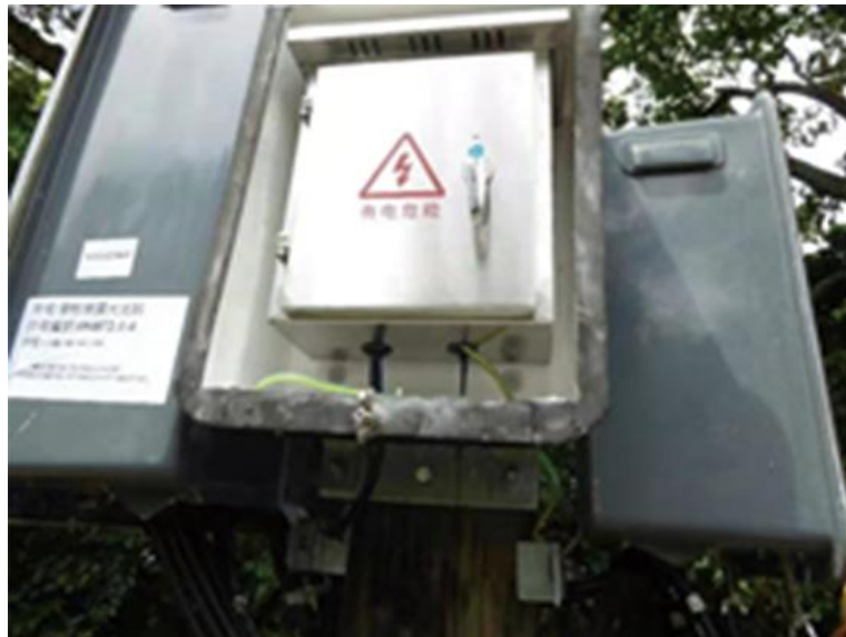
台区变监测项目
