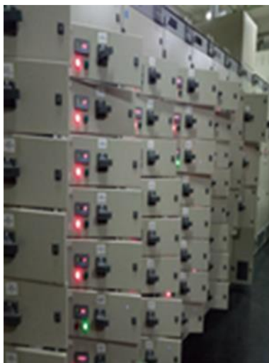
工厂智能配电房项目 (东莞垒石工厂电力监测应用)
