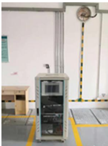
环境智能化辅助监控应用 (国网居配环控项目)
